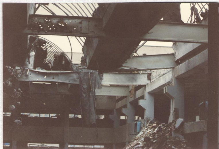
شدت انفجار، تیرآهن سراسری سوله کارگاه را تخریب و بتون را از جا کنده‌است.
